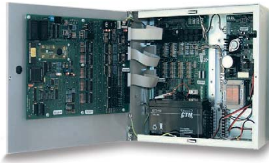
Alarmanlage mit integrierter CT Batterie
